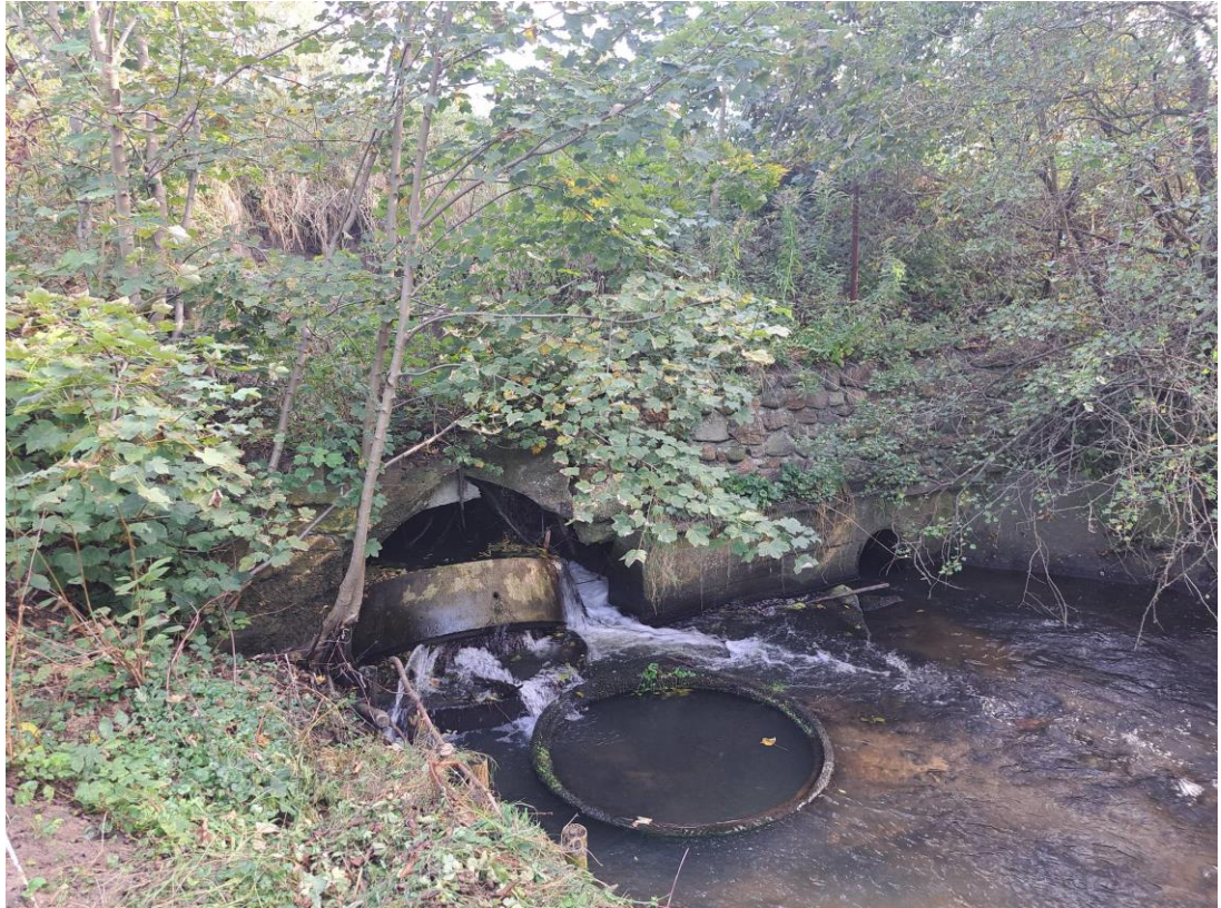
Rys. 1. Stan istniejący- widok od strony wylotu przepusty
